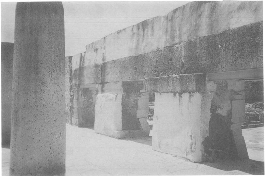
Foto No. 4. Cavidades formadas por el desprendimiento de xenolitos en las columnas, así como en los dinteles.
